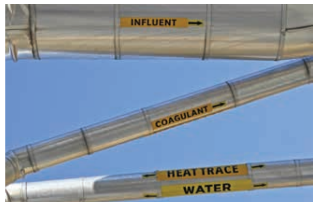
Leitungskennzeichnungen in Industrieumgebungen
